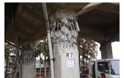
東日本大震災での鉄道被害
